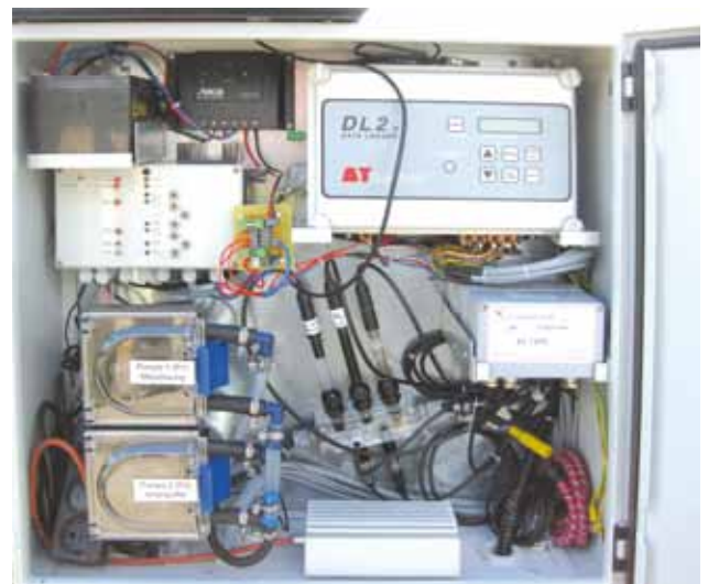
Abb. 1: Messtechnik für automatische Wasserbeprobung auf dem Reitplatz
