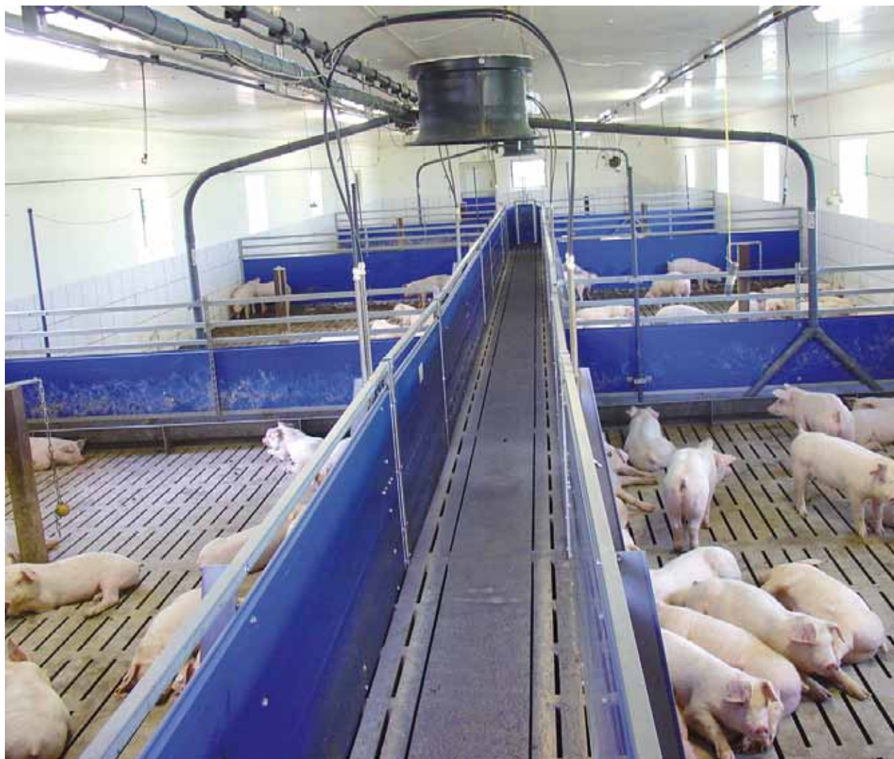
Abb. 1: Versuchsabteil mit Hochdruck-Vernebelungsanlage zur Kühlung
